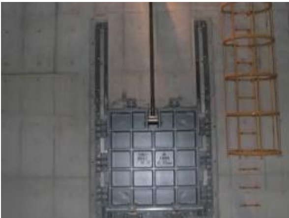
写真⑧ 庭窪浄水場吸水井ゲート（铸铁製電動式制水扉）
