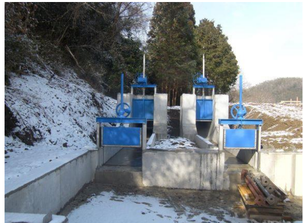
写真⑨ 仁位井堰（鋼板製手動式スライドゲート）
