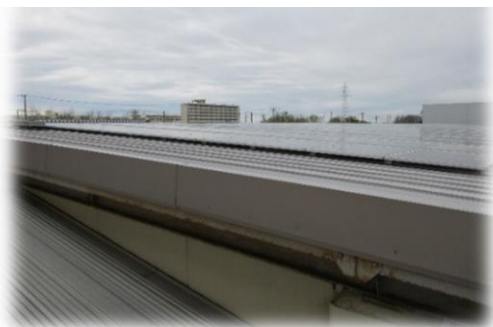
写真 自社の工場屋根に設置している太陽光パネル
