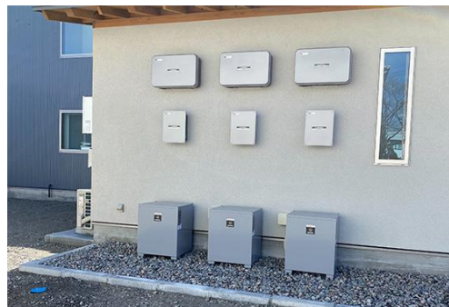
蓄電池の設置
