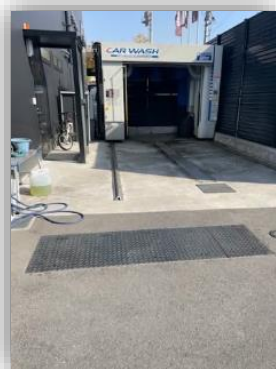
写真① 油水分離槽（外観）
