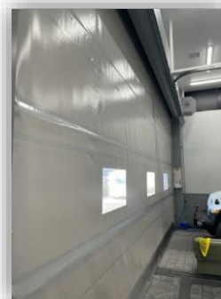
写真⑤エアカーテン
