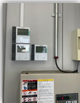
写真③冷暖房管理システム
