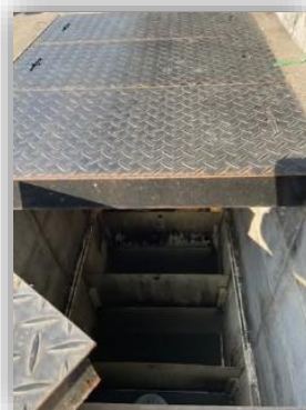
写真② 油水分離槽（内部）（商工中金経済研究所撮影）
