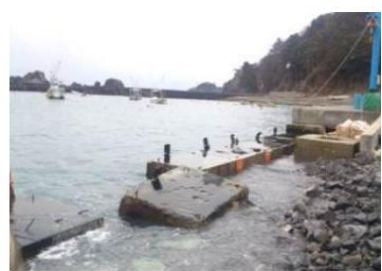
被災した現場（宮城県）
