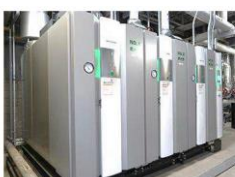
高効率ボイラー導入
