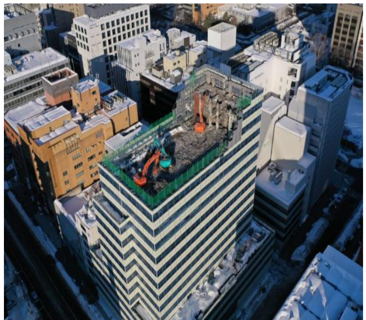
写真：(仮称)札幌南1条プロジェクト既存建物地上解体工事
