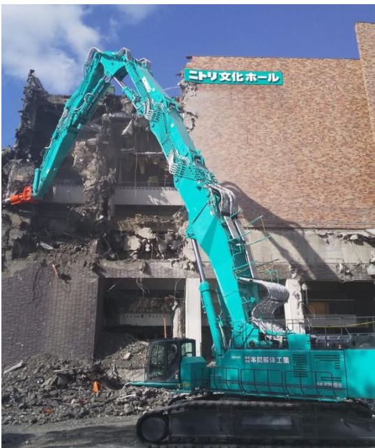
写真：さっぽろ芸術文化の館解体工事 (出所) 本間解体工業 HP
