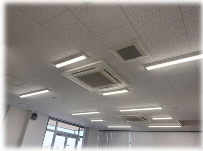
【切替済みのLED照明】
