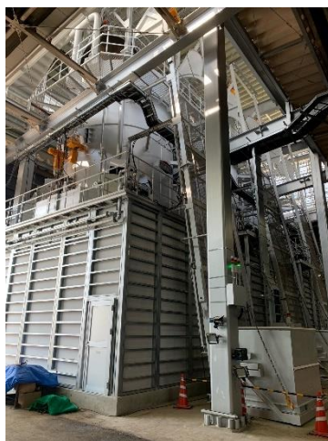
▲乾溜ガス化炉と投入バケット
