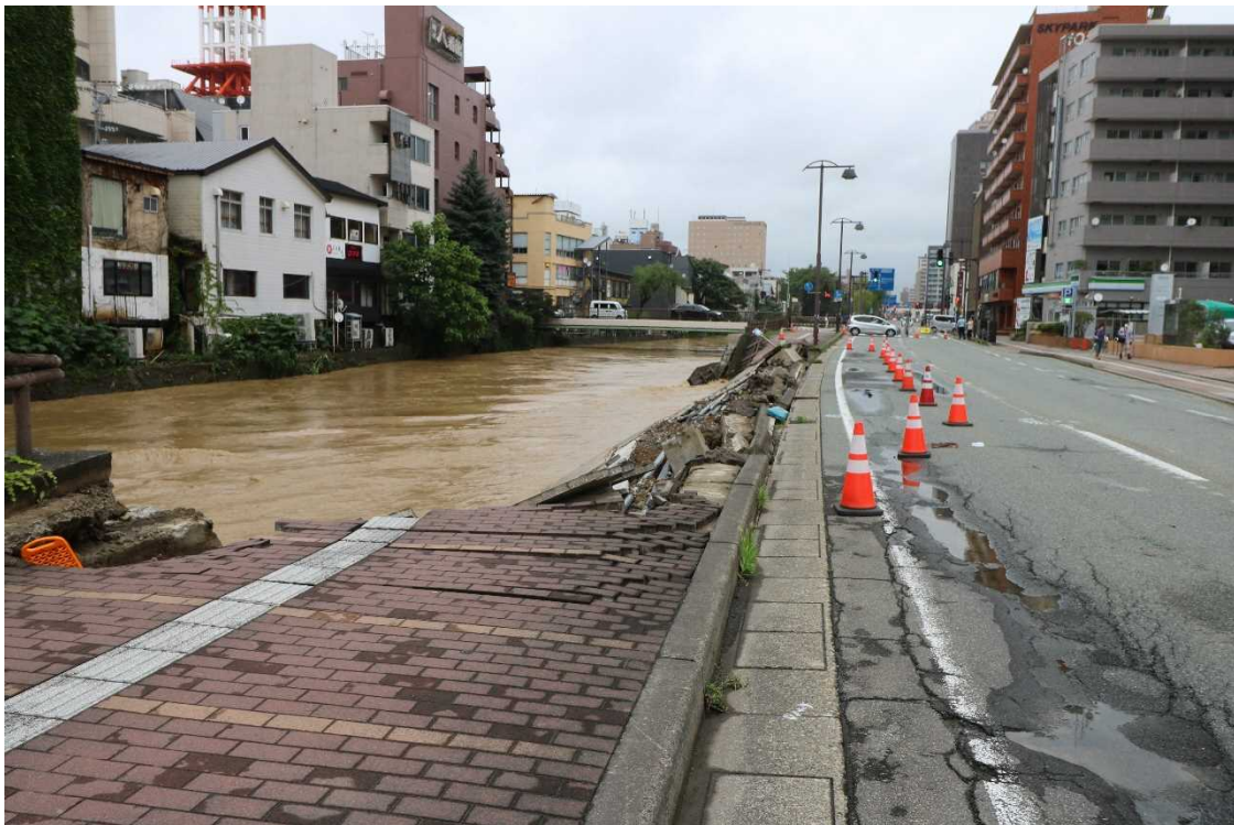
図 5：2023年7月大雨被害状況（旭川 河川浸食による護岸崩壊の様子） 20
