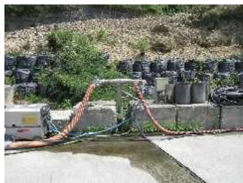
地下水くみ上げ設備
