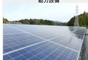
太陽光発電設備
