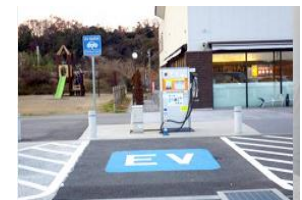
EV急速充電スタンド
