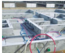
ベタ基礎と床下配管
