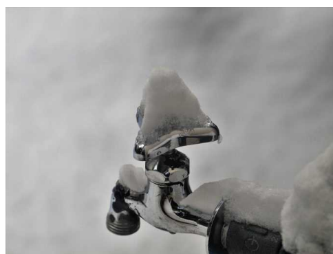
水道管の凍結
