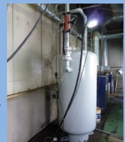
▶エア流量測定の様子
