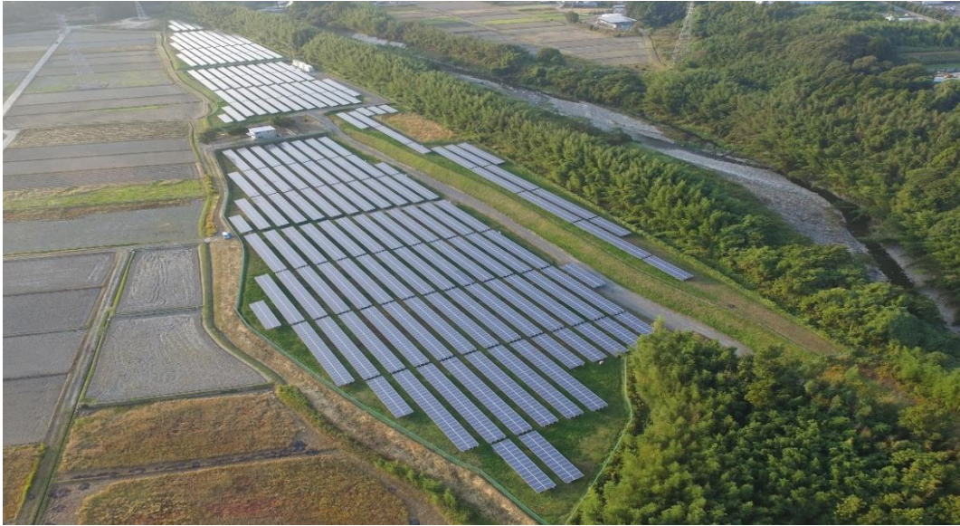
四日市市鹿間町 2.4MW
