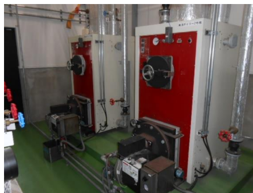
＜廃油ボイラー＞
