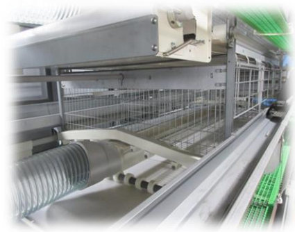
写真④：除糞ベルト・糞管 当社より提出
