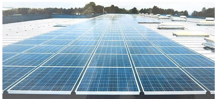
写真⑩ 本社工場屋根上に設置した太陽光発電設備 (出典：熊本菓房提供)
