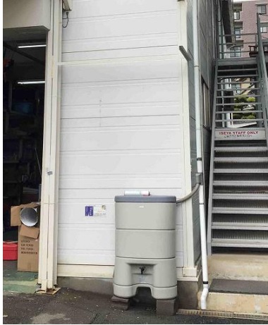
<雨水貯留タンク>
