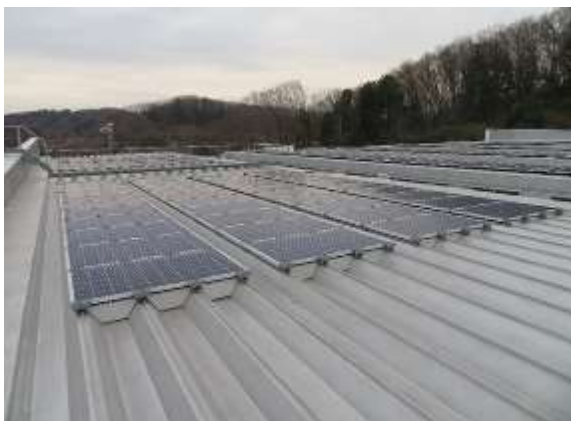
太陽光パネル300枚を設置した屋上
