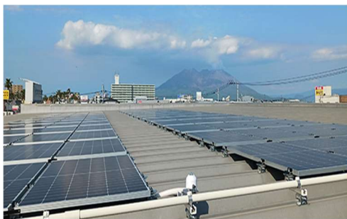
本社・太陽光発電設備
