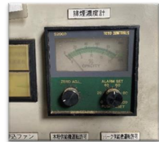
木くず焚きボイラー監視メーター 当社より
