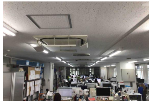
<「LED照明に切り替えた本社事務所」>
