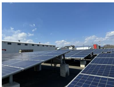
太陽光パネル
