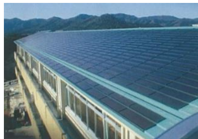
③太陽光発電設備施工例（体育館）
