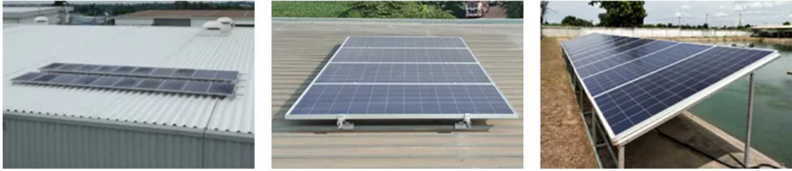
図 15 タイ工場に設置されたソーラーパネル 18
