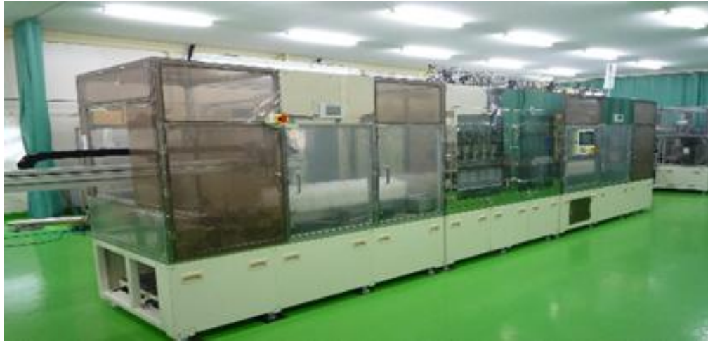
(写真①) 注液装置
